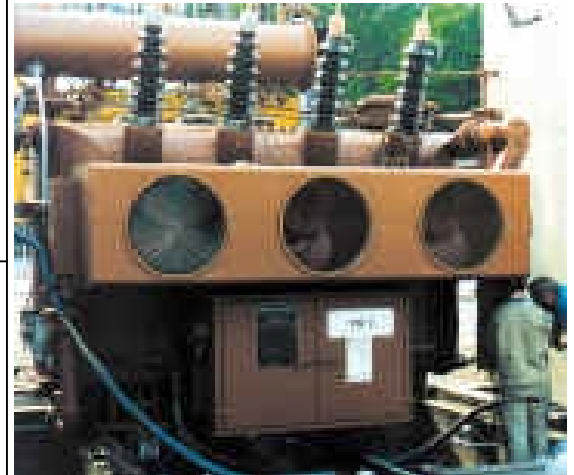
Transformateur 10 MVA 63KV / 20 KV avec refroidissement forcé dans l'huile .
